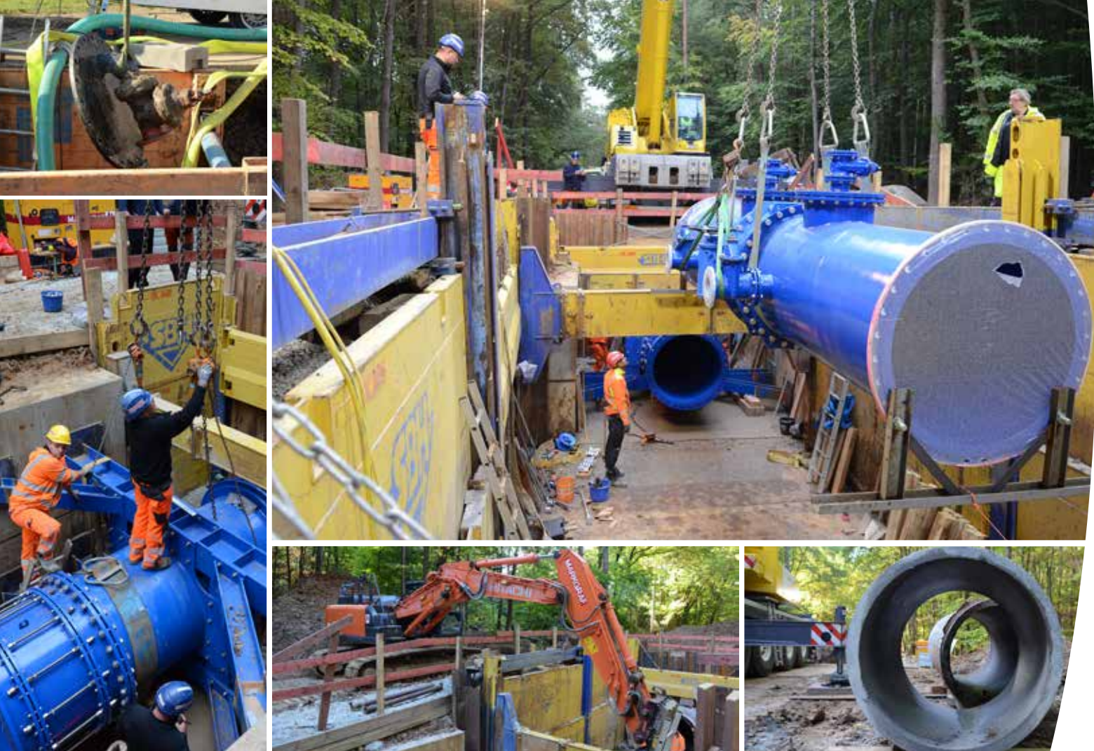
Am frühen Abend des zweiten Tages wird das längste Teilstück an Ort und Stelle gebracht (oben rechts). Die alten Rohre aus Spannbeton (unten rechts) sind nicht defekt, um die Versorgungssicherheit weiter zu verbessern wurden jedoch die neuen Elemente mit Absperrklappe eingebaut. Parallel werden Wartungsarbeiten an zwölf weiteren Betriebspunkten vorgenommen (oben links).
