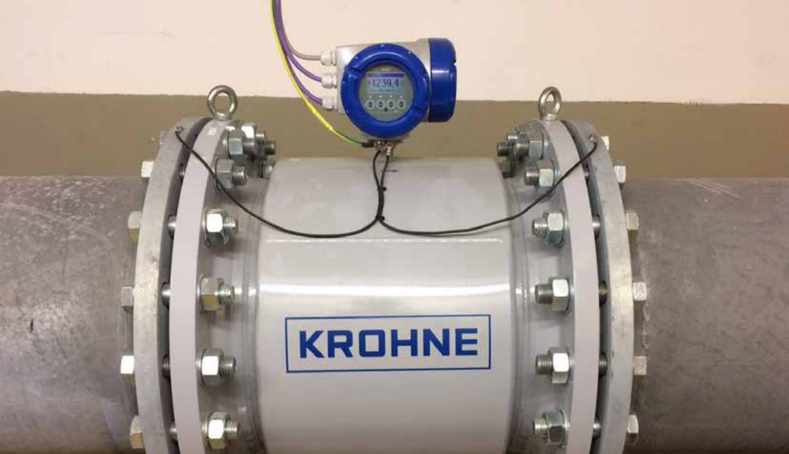
Das Wassernetz braucht solche elektronischen Wasserzähler wie diesen, der im Gewinnungsgebiet in Nidda-Kohden eingesetzt ist. Es handelt sich um einen modernen Wasserzähler mit höherer Genauigkeit als sie ein mechanischer Wasserzähler hat.
