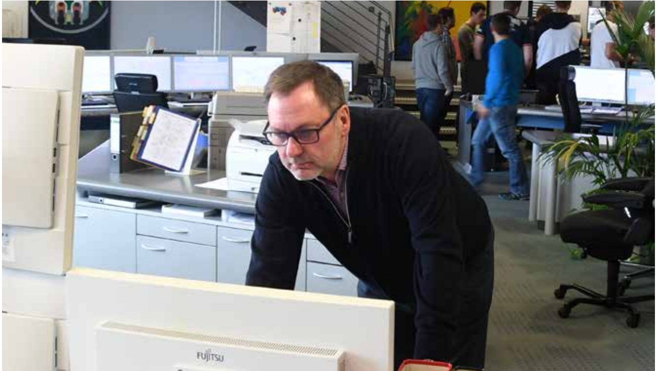
Ottmar Krüger kann von der Verbundleitstelle aus mit den Unterstationen kommunizieren.
