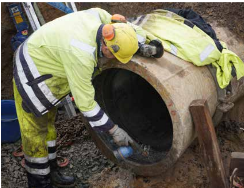
Nachdem das defekte Rohrstück entnommen (rechts, oben) und der Anschluss vorbereitet wurde (links) lassen die Monteure das speziell angepasste Rohr langsam in die Grube senken, um es an die alte Wasserleitung anzuschließen.
