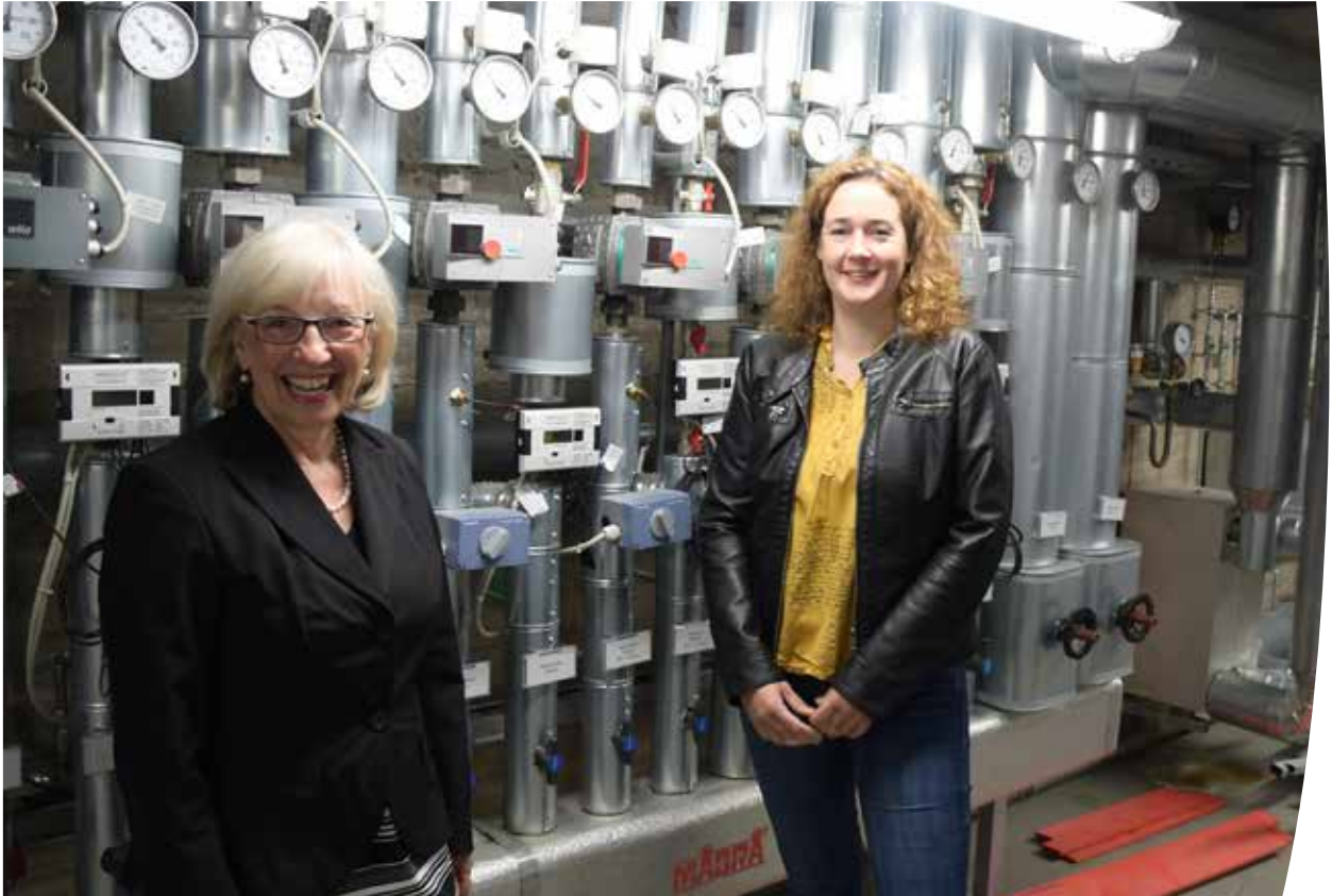
Pia Heidenreich-Herrmann (l.) und Maria Jansen (städtische Energieberaterin) in der jetzt richtig eingestellten Heizkreisverteilung der Stadt.
