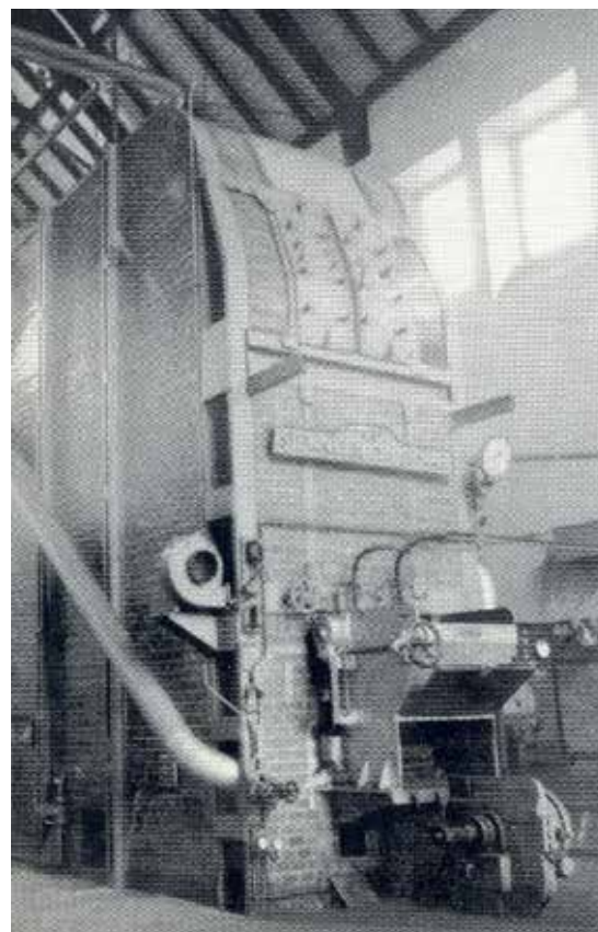
1909: Der Brunnen II in Inheiden wird gebohrt, im Vordergrund sprudelt schon Brunnen I (ganz unten). Gepumpt wird das Wasser später von der Turbopumpe (Mitte), betrieben durch die zugehörige Dampfkesselanlage (oben).
