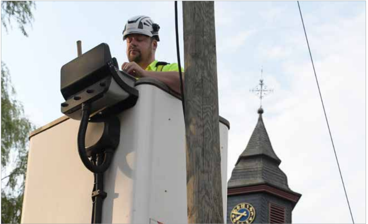
Thorsten Roth und seine Kollegen warten und reparieren das Stromnetz und die Straßenbeleuchtung.
