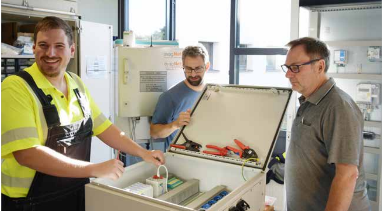
Marius Harpel, Dirk Schneider und Ottmar Krüger (v. l.) bei der Abstimmung der EEG-Box zum Regeln einer Erzeugungsanlage.
