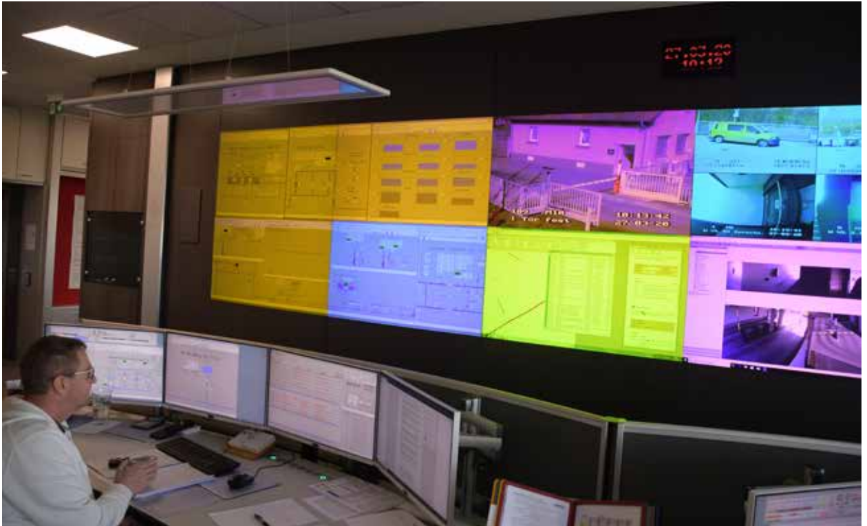
Gesicherte Netzüberwachung unter erschwerten Bedingungen mit „Split Teams“ und räumlicher Abschottung
