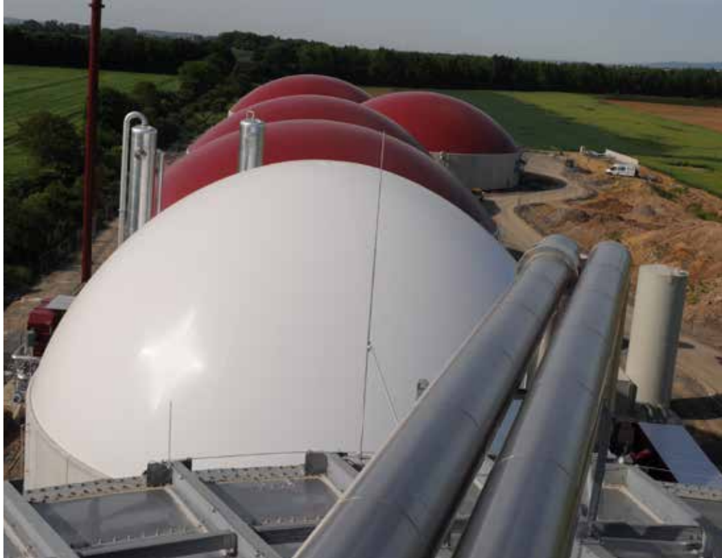
Ebenso Teil der eigenen Stromerzeugung: die Biogasanlage in Wölfersheim-Berstadt
